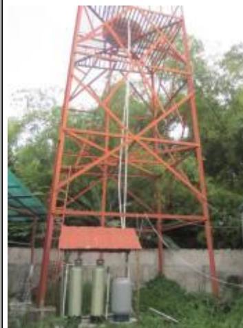
シャワー・洗面所の水を 浄水する大型浄水機
